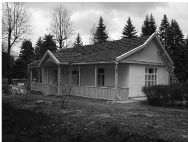
Фото 3. Будинок-музей Марка Вовчка під час ремонту у березні 2010 р. (фото автора статі)
