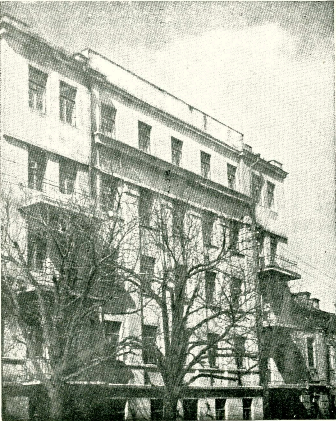
Жилий будинок на Обсерваторній вулиці (Київ) — приклад неохайного виконання фасаду.
