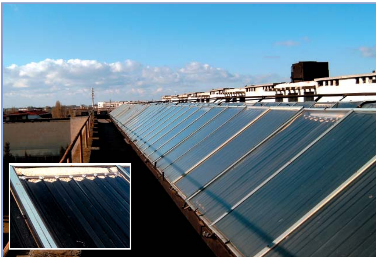
Сонячні колектори на даху пансіонату "Північний", АР Крим
