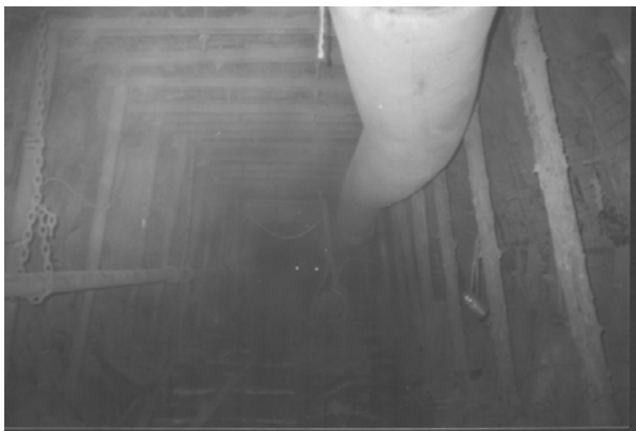
Рис. 2. Состояние крепи в конвейерном штреке северной коренной лавы пласта k_8^H
