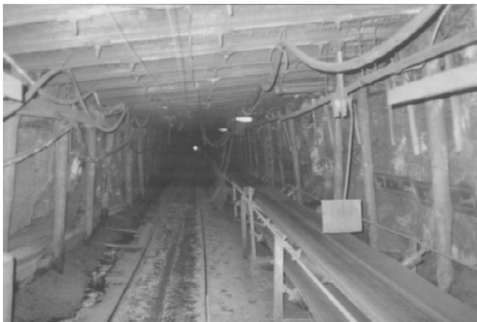
Рис. 4. Состояние крепи штрека вне зоны влияния очистных работ
