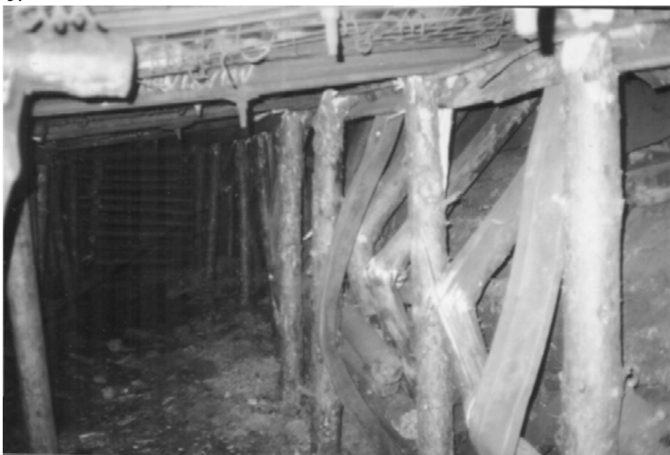
Рис. 5. Состояние штрека в зоне влияния очистных работ (2 м за лавой)
