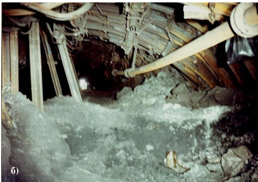
Рис. 3 Состояние крепи конвейерного штрека при 2-х симметричных (а) и асимметричных продольных балках соответственно на расстоянии 120 и 230 м от лавы
