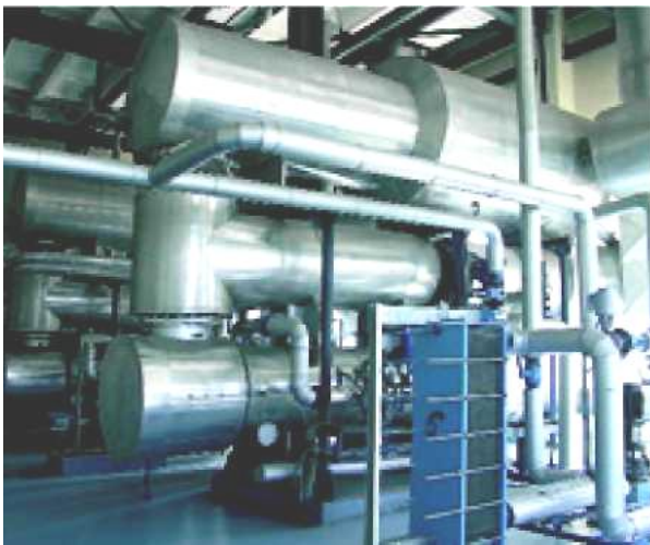
Рис. 2. — Зал теплообменного оборудования
