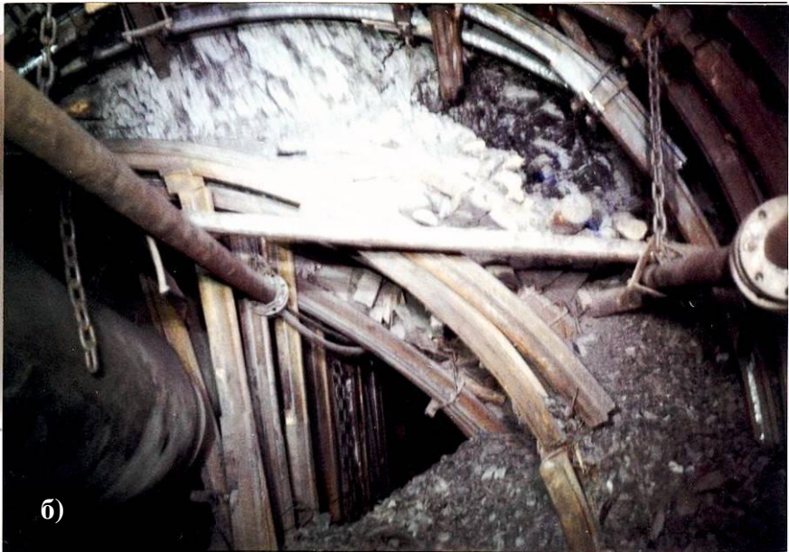
Рис. 2 Состояние крепи конвейерного штрека без крепи усиления на расстоянии 120 (а) и 230 м (б) от лавы
