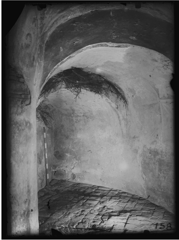
Мал. 2. Приміщення у нижній частині північної вежі. Стан до реставрації. 1935 р. Фото з наукового архіву НЗСК. КП – 212. Інв. № 4191.
