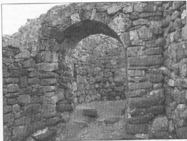
Рис. 44. Цилиндрическая арка ворот крепости Фуна второго строительного периода после реставрации (вид с севера)
