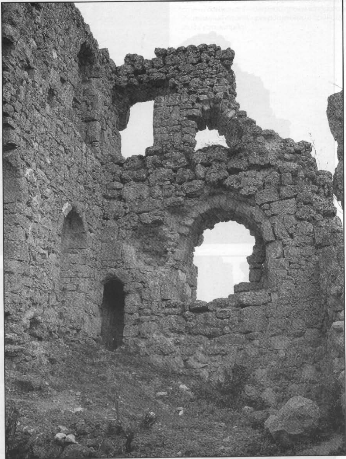
Рис. 257. Юго-восточная стена донжона цитадели Мангуна с туалетной комнатой, дверными проёмами, окнами и нишами (вид изнутри и северо-запада)
