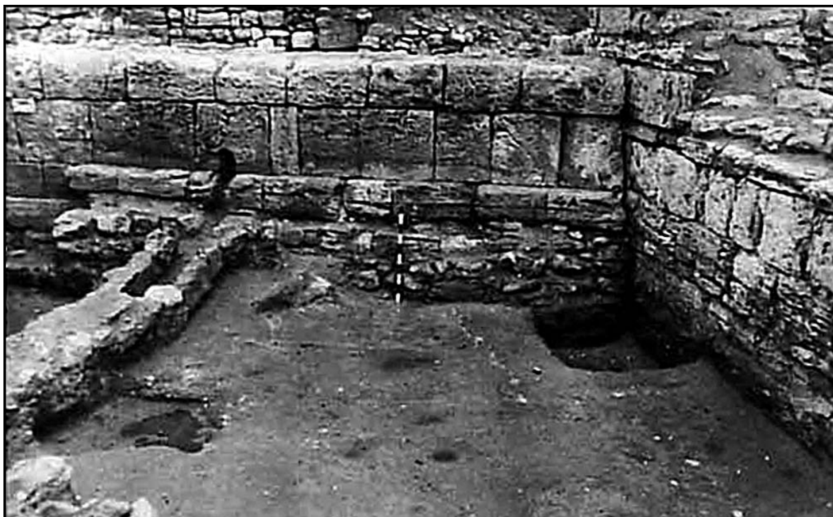
Рис. 4. 25 куртина V строительного периода. Квадровая кладка наружной облицовки. Справа – стык с башней XXII [3, рис. 270]
