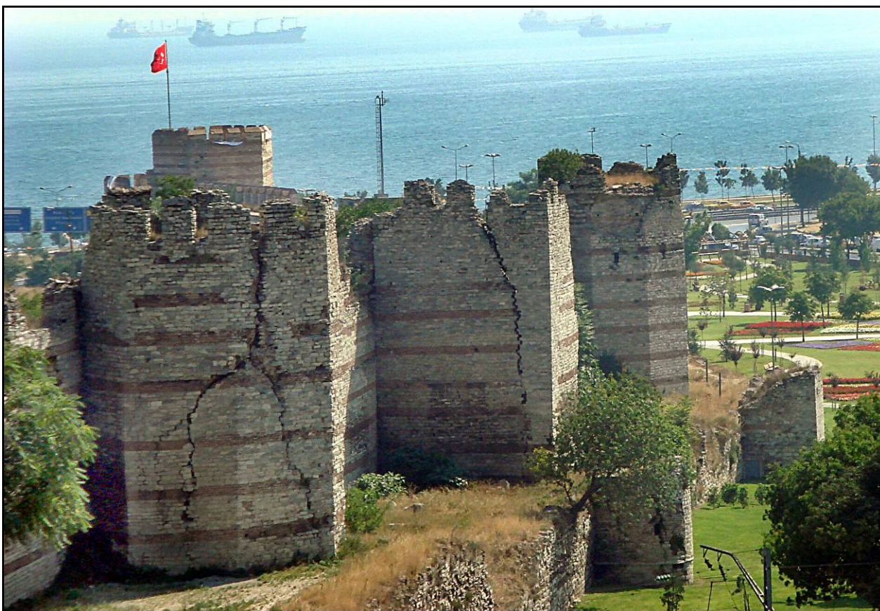
Рис. 18. Башни южного фланга «Стены Феодосия» (южнее Золотых ворот) со следами сильного сейсмического воздействия. Стамбул. 2007 г. Снято с северо-востока (фото автора)
