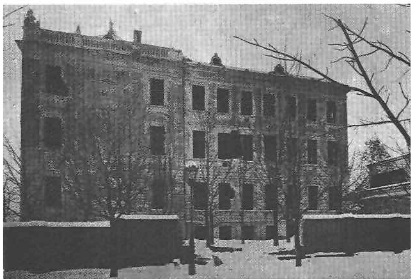
SZKOŁA KADECKA (prawe skrzydło budynku ostrzeliwane przez artylerię ukraińską) kwatery komendy pododcinka
