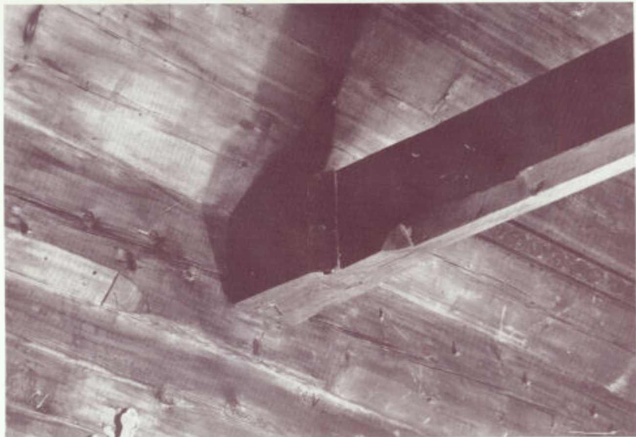
125. Powroźnik, Polska. Cerkiew par. gr.-kat. część pd. szczytu poprzecznego w namie oraz dekoracja uskoku: 1604
